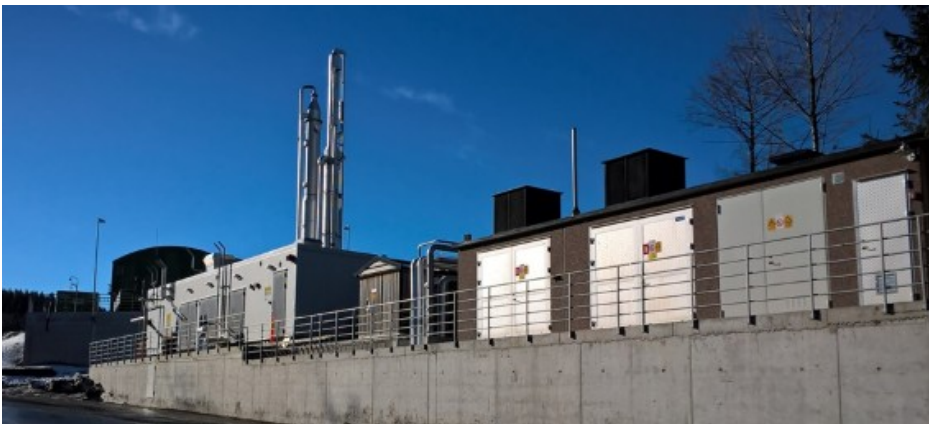
Billede 6. Purac opgraderingsanlægget til opgradering af biogas til bio-metan. Til venstre teknik-bygning og til højre kompressorstation med videre. Foto: Niels Østergaard.
